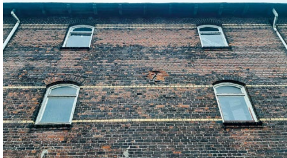
Schäden an der Fassade des Lagerhaus G. Foto: Initiative Dessauer Ufer.
